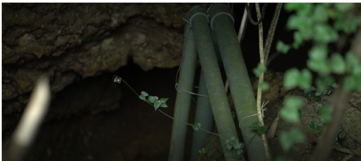
Gambar 7. Pipa-pipa saluran air warga dari Mata Air Goa Menggah, Desa Pasucen, Rembang Figure 7. Water pipes for residents from Goa Menggah Spring, Pasucen Village, Rembang
